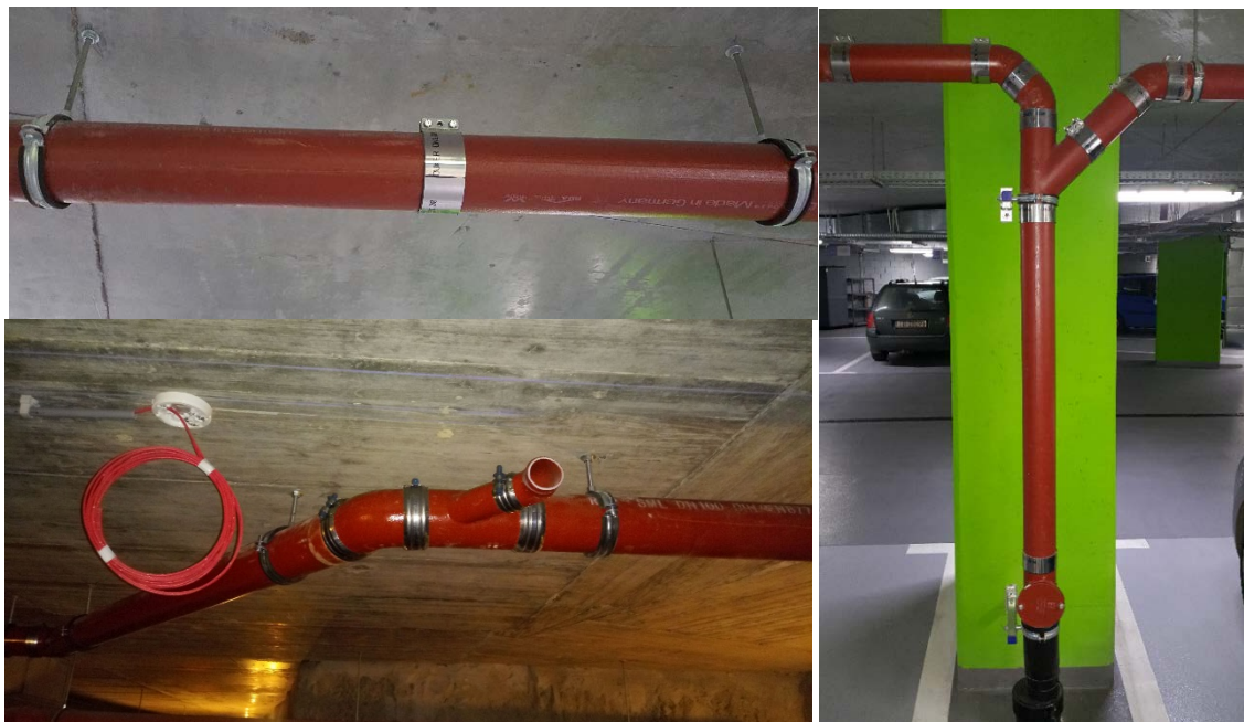
Fig. 3.81 Foto Frammento di un'installazione fatta di tubi SML, usando morsetti di tipo CV (immagine di proprietà dell'autore)
