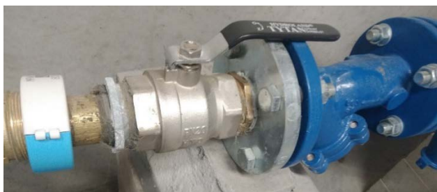
Fig. 3.32 Foto Frammento di un sistema di approvvigionamento idrico collegato con raccordi con un giunto filettato (sul lato sinistro) e un giunto flangiato
