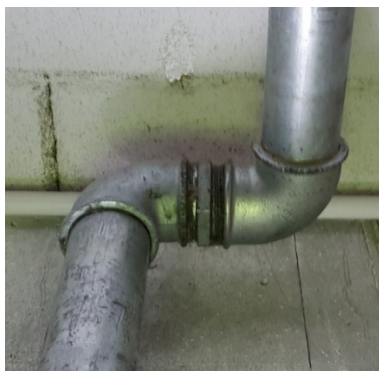
Fig 3.31 Foto Frammento di un sistema di approvvigionamento idrico costituito da tubi zincati con giunti filettati.
