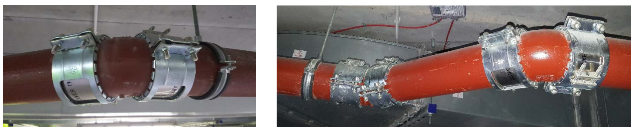
Foto Frammenti di un'installazione fatta di tubi SML, usando morsetti di tipo CV, rinforzati con artigli di serraggio (immagine di proprietà dell'autore)
