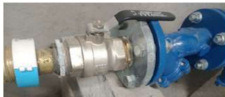
3.32 pav. Vandentiekio sistemos, sujungtos su sriegine jungtimi (kairėje pusėje) ir flanšine jungtimi, fragmentas.
