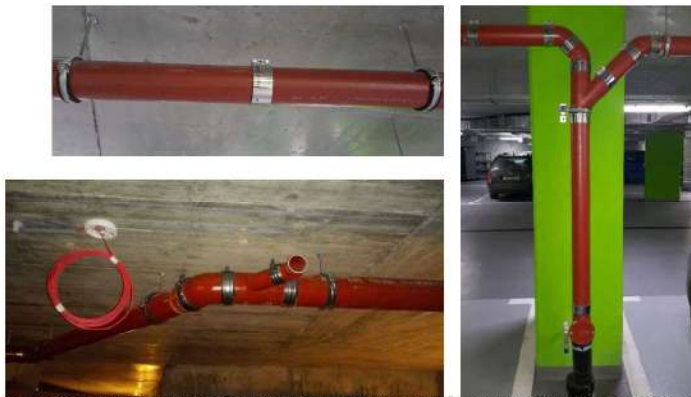
3.80 pav. Kanalizacijos sistemos fragmentai, sumontuoti iš SML vamzdžių, naudojant metalinių apkabų jungtis.
