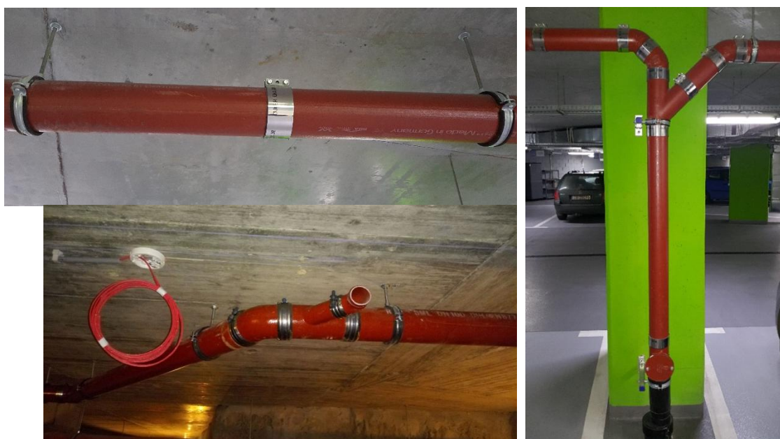
Rys. 3.80. Fragmenty instalacji wykonanej z rur SML, przy wykorzystaniu połączeń obejmami typu CV (źródło własne)
