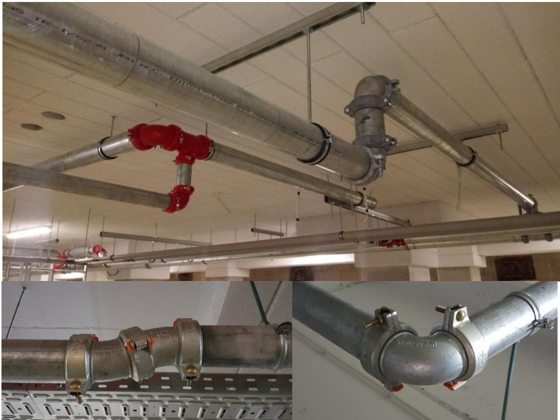
Rys. 3.33. Fragmenty instalacji wodociągowych z rur ocynkowanych łączonych w systemie rowkowanym oraz gwintowanym, część a. (źródło własne)
